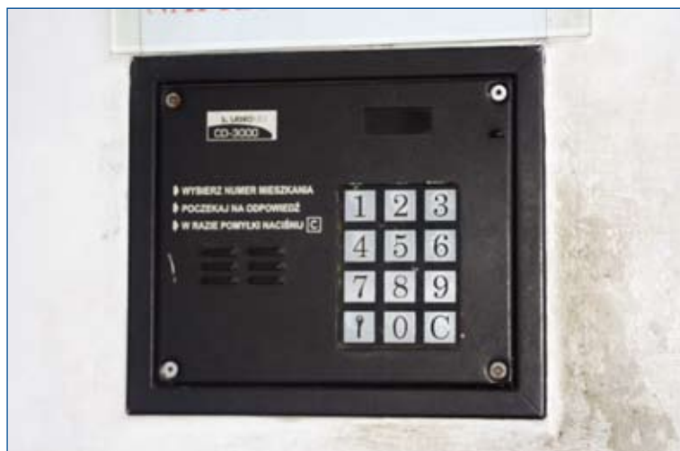
Fot. 9. Domofony z przyciskami sensorycznymi nie spełniają wymogów dostępności (zdj. M. Wysocki).
