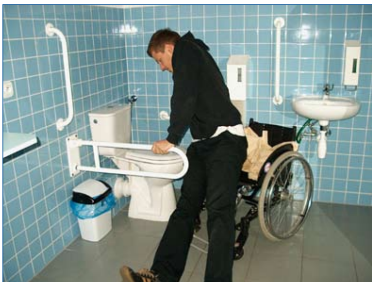
Fot. 13. Dobrze zaprojektowana toaleta powinna ułatwić osobie niepełnosprawnej przesiadanie się z wózka na miskę ustępową (zdjęcie wykonane podczas warsztatów „Miasta bez barier”).
